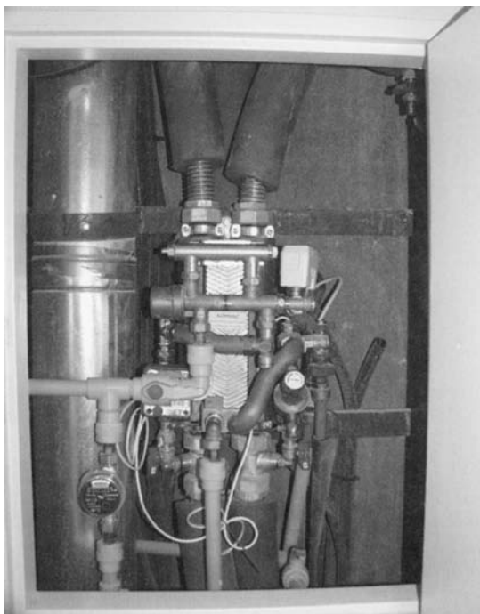
Domovní výměníková stanice
