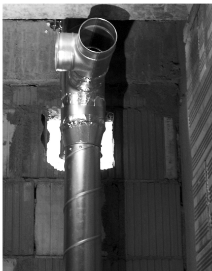
Obr. 10 Roura vzduchotechniky v bytovém jádře
