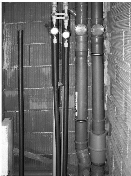
Obr. 3 Rozmístění trubních vedení v nezazděném bytovém jádře
