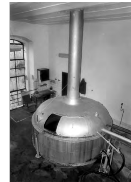
Březnice, mladinová pánev dvojnádobové varny, provozně sloučená se rmutovacím kotlem (foto autora, 2008).
