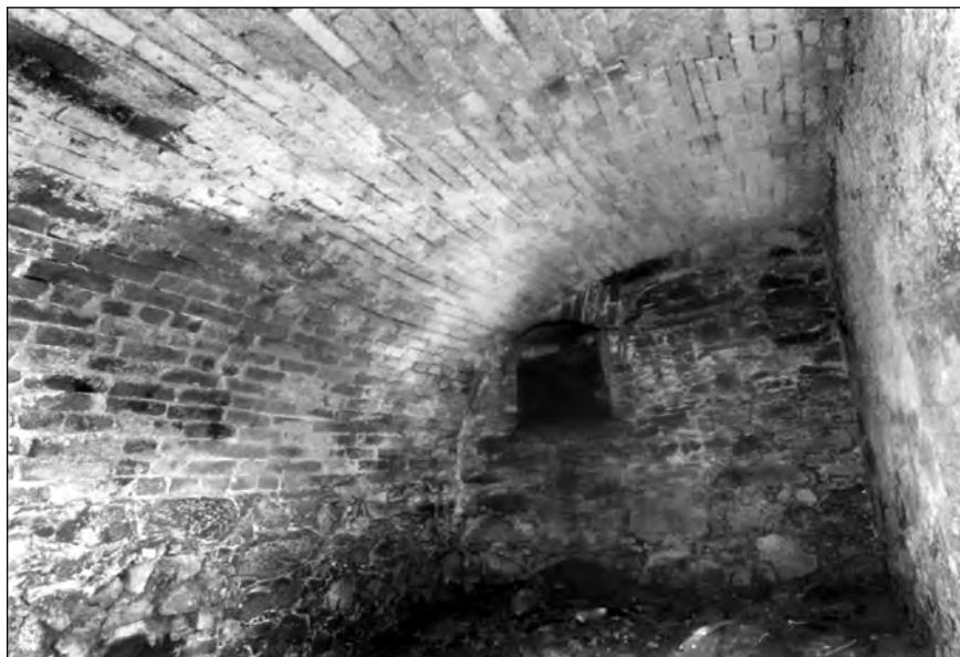
Boudy u Mirotic, část ledničního sklepa zaniklého pivovaru – v pozadí šikmo vedený sňoz pro led (foto autora, 2008).
