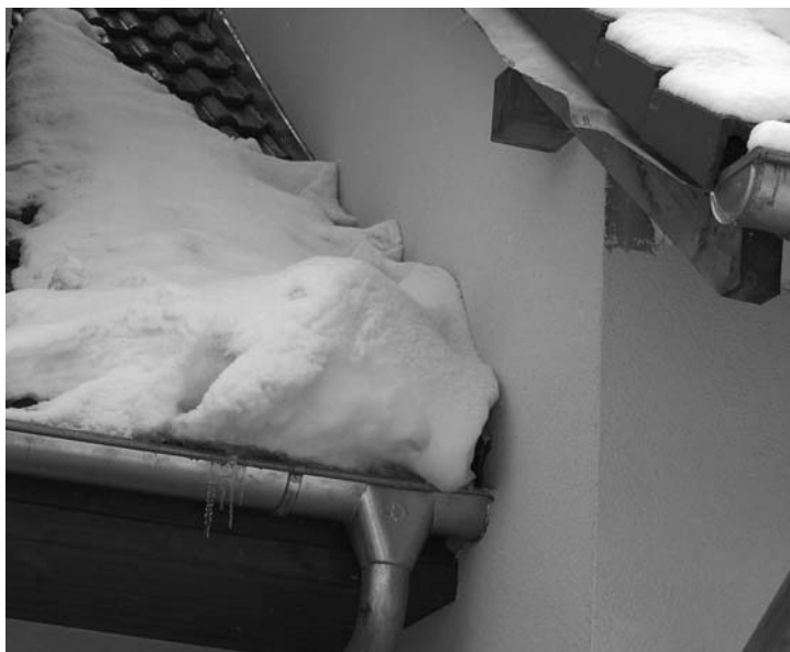
Obr. 3 Sníh, který přiléhá k obvodové stěně, může kvůli nedostatečné výšce plechového lemování způsobit její nadměrné zavlhčení. Pokud je lemování navíc provedeno chybně, při tání sněhu dojde k zatékání vody do střešního pláště
