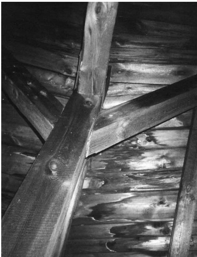
Obr. 2 Nadměrná vlhkost dřevěného bednění šikmé střechy způsobená srážkovou vodou v důsledku netěsnosti skládané střešní krytiny
