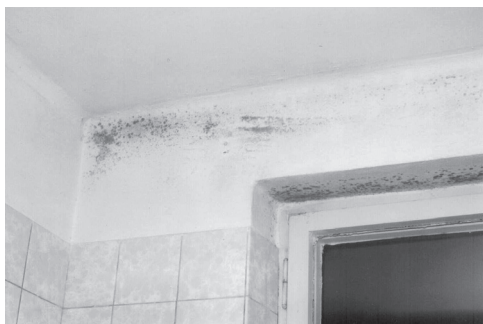
Obr. 1.4 Povrchová kondenzace s výskytem plísní v místě tepelně poddimenzovaného překladu
